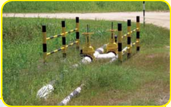
Pijpleiding in het olieveld
