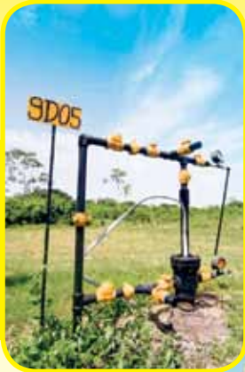
Pijpleiding in het olieveld
